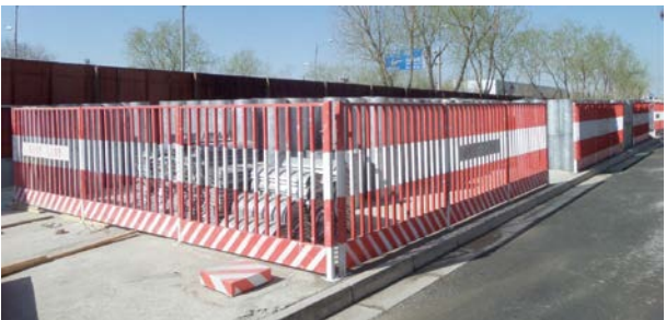
现场材料存放区分类分隔、加设隔断
